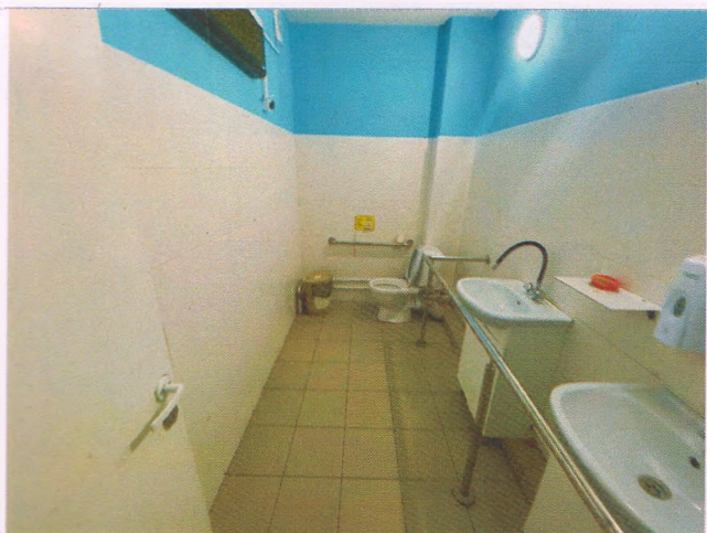
Фото №35– Санитарно-гигиеническое помещение. Поручни, кнопка вызова помощи со шнурком.
