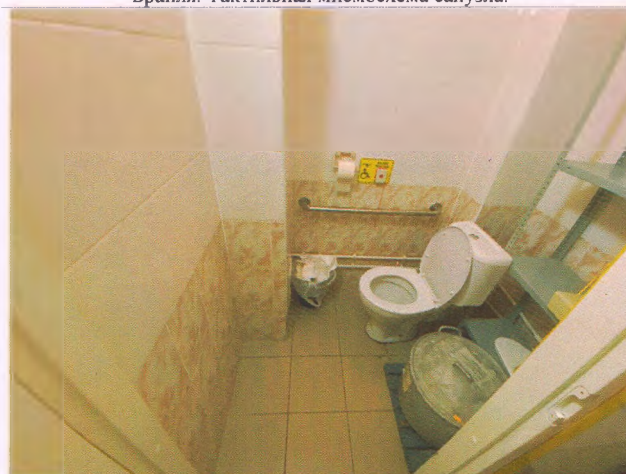
Фото №40 – Санитарно-гигиеническое помещение. Поручни, кнопка вызова помощи со шнурком.
