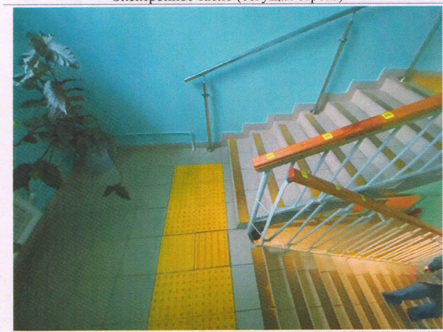
Фото № 16 – Пути движения внутри здания (лестницы). Тактильные напольные указатели.
