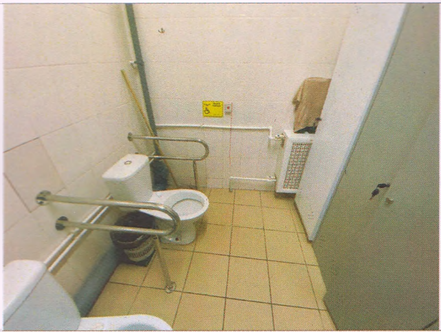
Фото №37 – Санитарно-гигиеническое помещение. Поручни, кнопка вызова помощи со шнурком.
