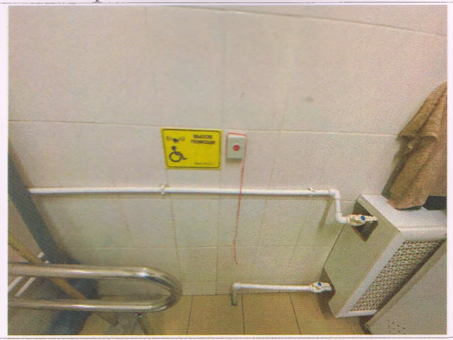
Фото № 38 – Санитарно-гигиеническое помещение. Поручни, кнопка вызова помощи со шнурком.
